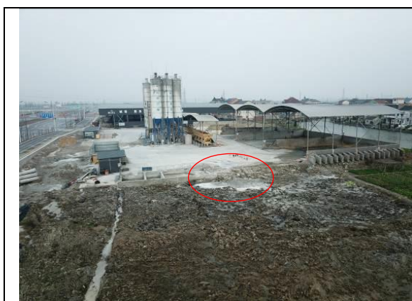
图 1-18 K4+800 右侧施工场地泥沙池泥沙外溢
