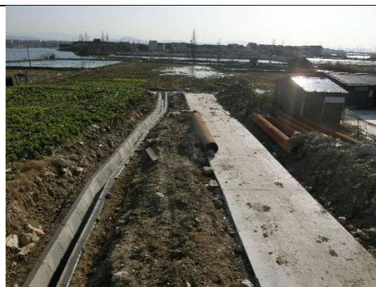
图 1-10 调查监测水土保持措施—施工场地 U 型临时排水沟
